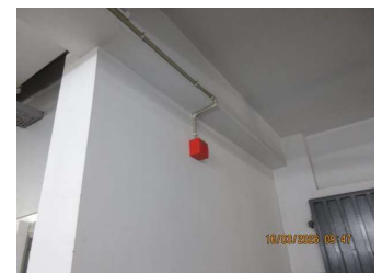
Fire alarm hooter.JPG
