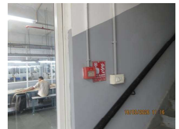
Fire alarm call point.JPG
