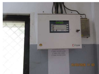
Fire alarm panel.JPG
