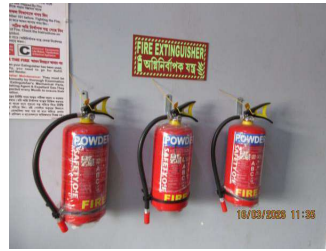
Fire extinguishers (2).JPG
